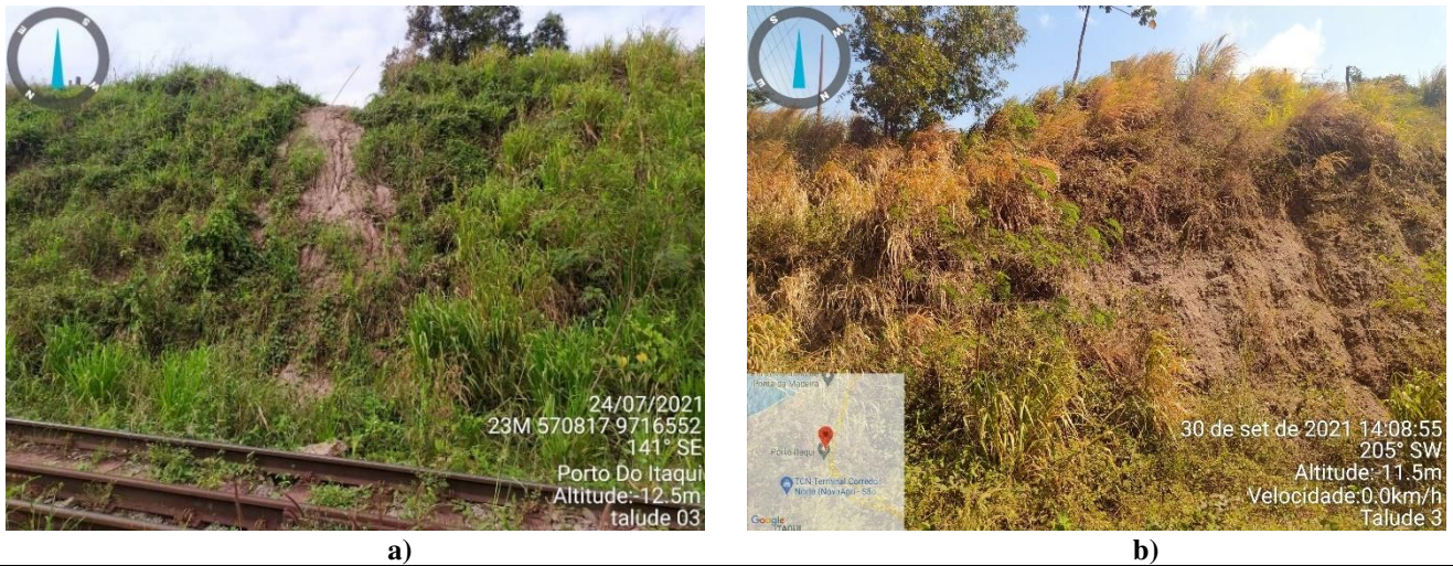
Figura 4: Pontos de erosão no Talude 03
